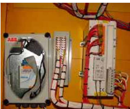
Conversor serie - Ethernet para lectura de medidores en subestación.
